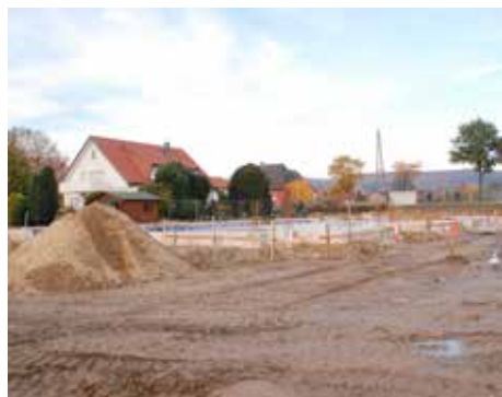
Die Baustelle von Charly's Kinderparadies an der Haller Straße im Stadtteil Aschen.
